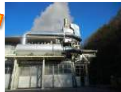
Calore industriale di scarto
