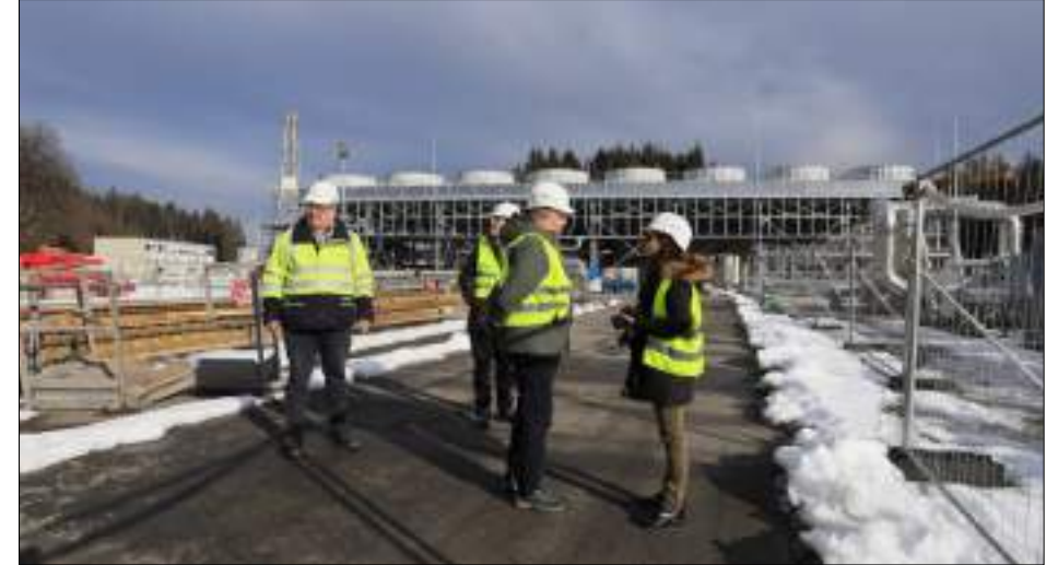
Impianto GeoTermoElettrico Tecnologia Eavor Loop, a Geresdried, in Baviera-Germania (3 febbraio 2026)
